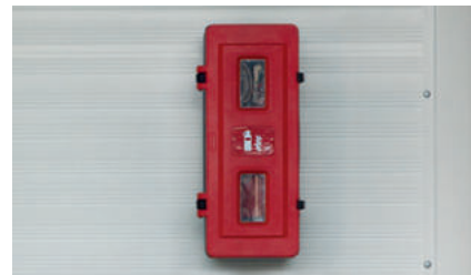
Feuerlöscher an der Vorderwand
